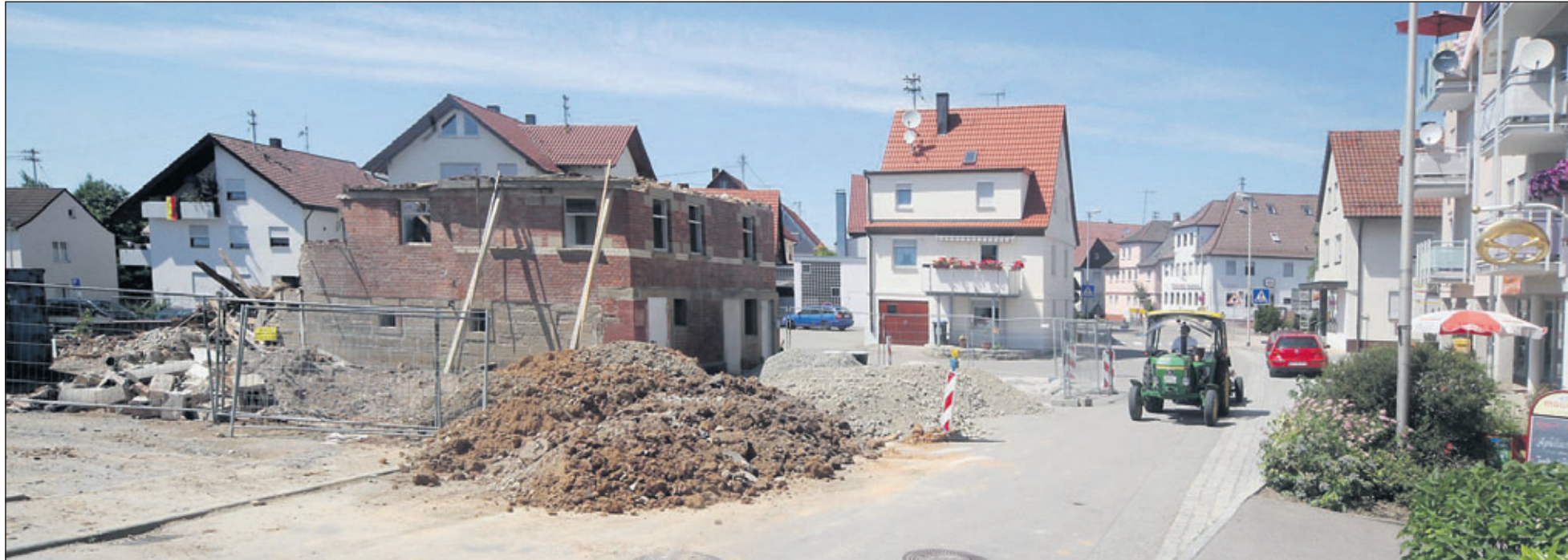
Ein Rest vom Haus an der Hauptstraße bleibt eine Weile stehen, bis die jungen Schwalben ausgeflogen sind.
