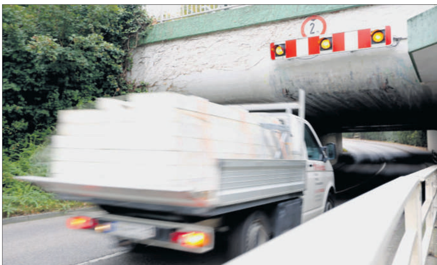
In der Beutelsbacher Bahn-Unterführung bleiben häufig Busse und Lkw stecken.
