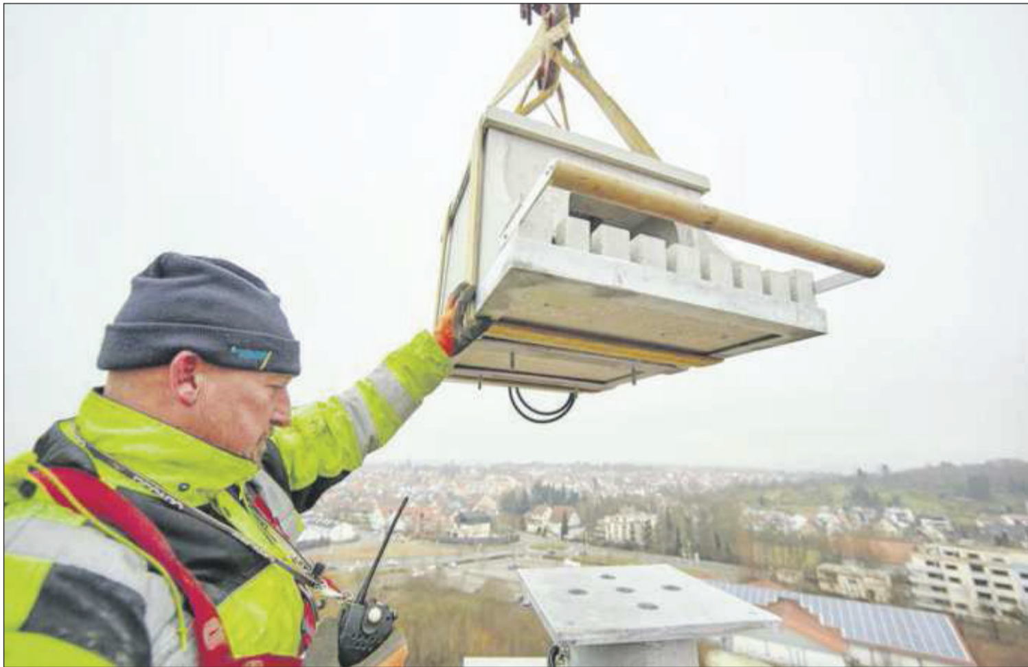
Der Wanderfalken-Nistkasten von der Größe einer Hundehütte schwebt in 26 Meter Höhe mit Blick auf den Aldi und Leutenbach ein.
